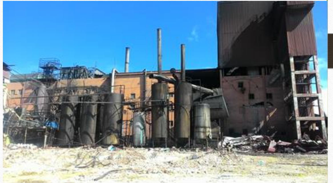
震損後，無法正常運作的民間煉油設施及廠房
